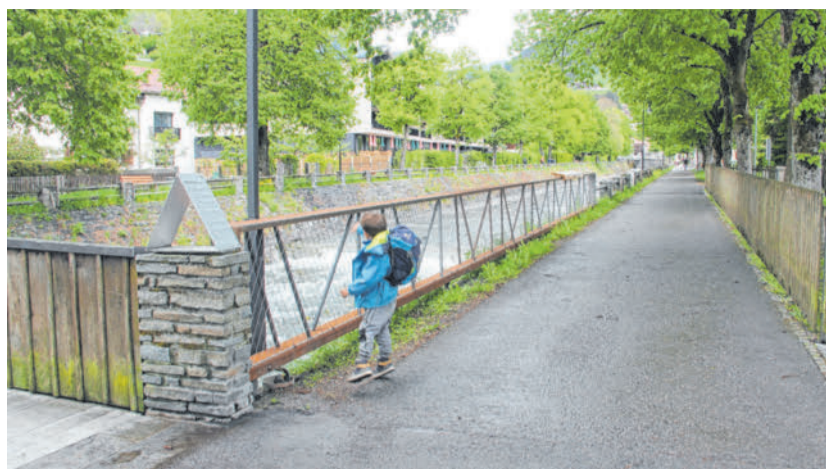
Die erste Baustufe des neuen Litzgeländers erstreckt sich beidseitig von der Kinobrücke in Richtung Schruns. STR
